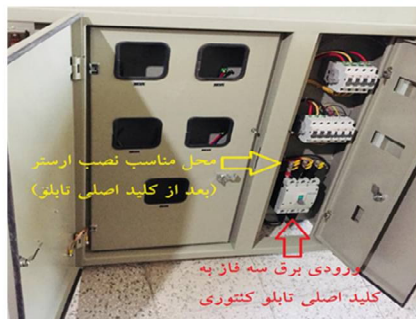
شکل ۳: محل مناسب نصب ارسر حفاظتی در یک تابلو برق کنتوری ۴+۱ واحدی مسکونی
